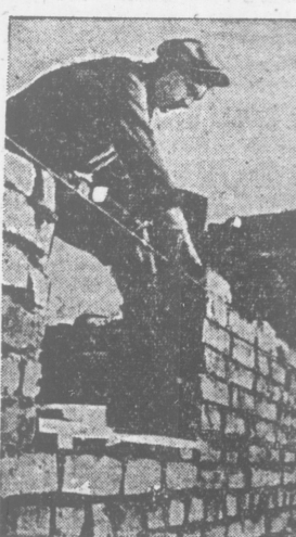
На строительстве Вильевского района «Альба» (Литва) каменщик З. В. Дауша, используя методы работы ленинградца Андрея Кузнецова, за три часа выложил 11 дневных норм, уложив около пяти тысяч штук кирпича.
