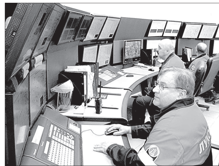
Центральный пульт управления.
