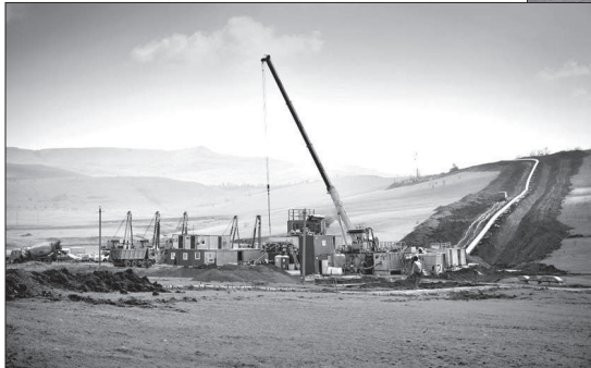
В ходе строительства газопровода КС «Изобильный» – Невинномысск успешно применяются уникальные технологии микротоннелирования и наклонно-направленного бурения. На фотографии – площадка стартового котлована тоннелепроходческого комплекса.
