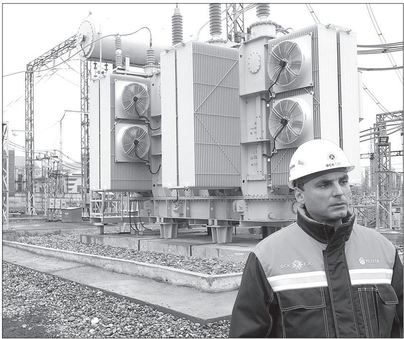
• За спиной начальника подстанции «Машук» Александра Иорданова новейшие силовые трансформаторы.
