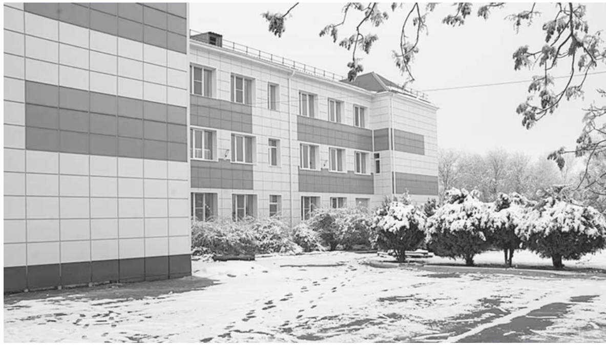
В школе № 8 села Тищенского Изобильненского округа начался второй этап капитального ремонта, стартовавшего в прошлом году. Работы идут в рамках краевого проекта модернизации школьных систем образования.
